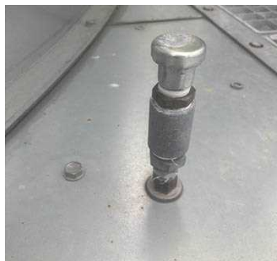
Respiradero en plataforma del ventilador
